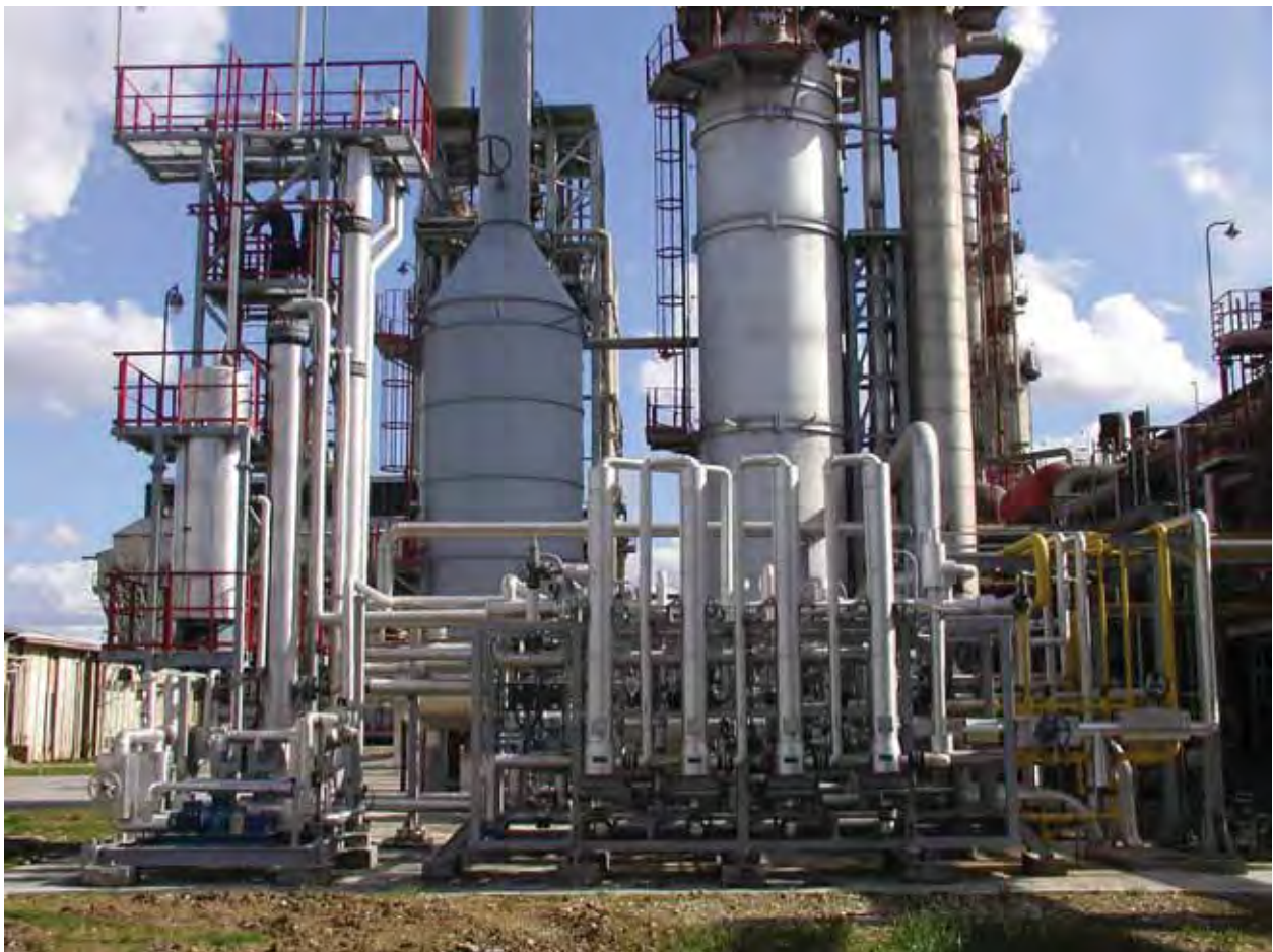
Slika 1. Jedinica za izdvajanje amonijaka i vodika na postrojenju Amonijak 2
