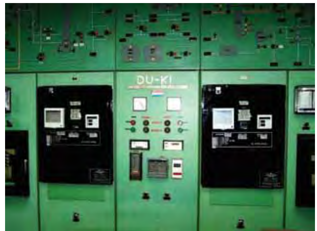
Slika 4. Kontrolna stanica i analizatori za DUKI 1
